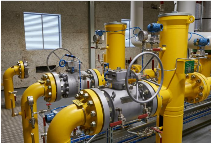
Gasregeltechnik im Einsatz. Branchenaufnahme von Novo AI bereitgestellt.
